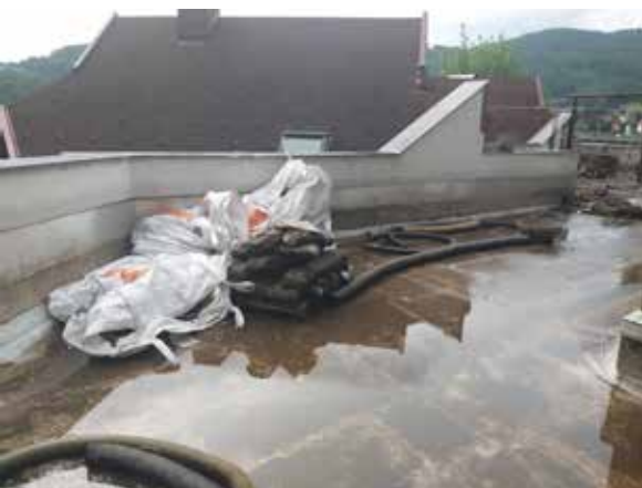
Überschwemmte Terrasse kurz vor Abschluss der Renovierung
