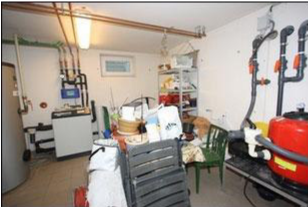
Abb.41 Ansicht Wohnhaus KG, Technik-/Heizraum
