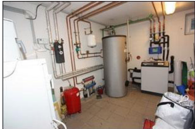
Abb.42 Ansicht Wohnhaus KG, Technik-/Heizraum
